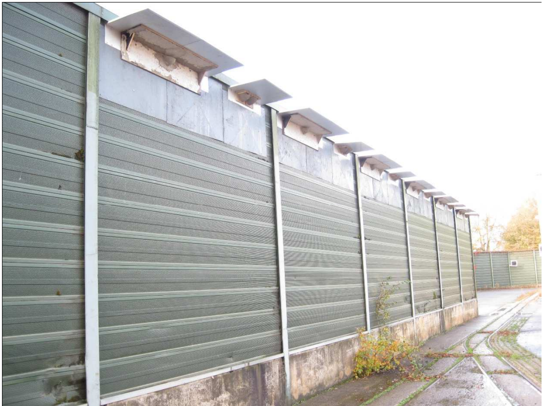
Abbildung 4: 8 Mehl - und 4 Rauchschnalbennester an der Westseite der LSW
